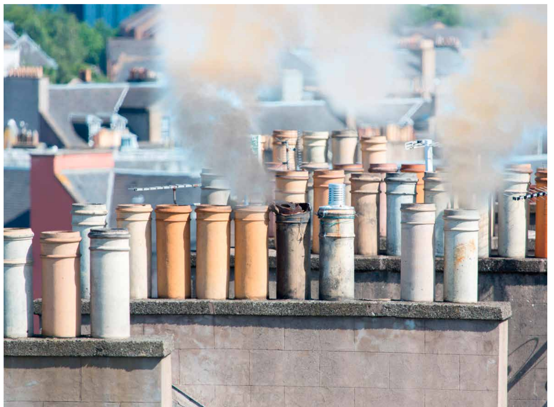
Die «dreckige» Abluft wurde durch Kamine in die Umwelt gelassen.
